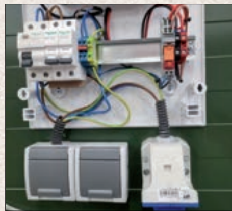
230V STROMANSCHLUSS ZUM BETRIEB EXTERNER GERÄTE
